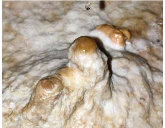
Unter dem Becken verwandelt eindringende Feuchtigkeit die Technikräume in Tropfsteinhöhlen. Foto: Markus Röck
